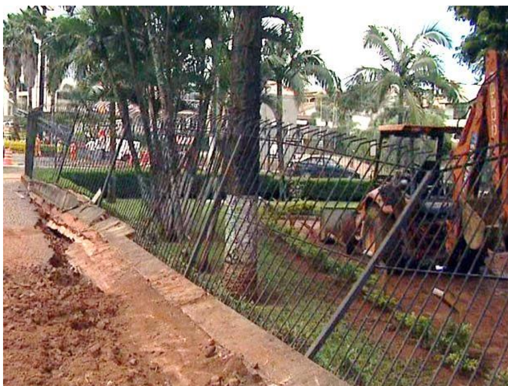
Figura 4 – Prédio do Fórum Comarca de Franca(SP) após eventos chuvosos
